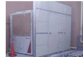
1面5段設置(扉付き)
