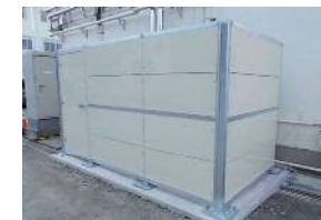
3面4段設置(扉付き)
